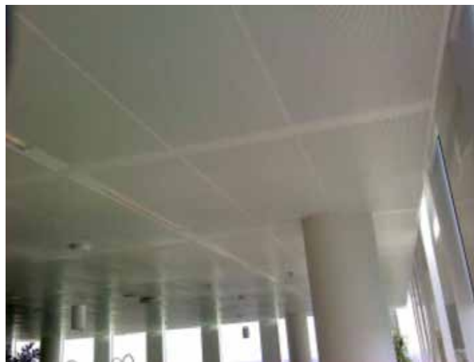
Bij de eindcontrole worden thermografische beelden gemaakt
